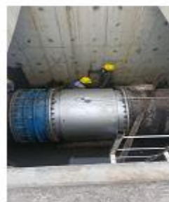
污水处理厂现场
